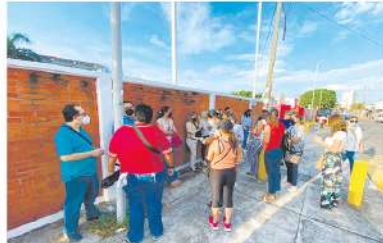
LOS INCONFORMES exigen reparación de techo y garantías de seguridad para alumnos. La escuela argumentó que un rayo provocó el colapso de una parte del inmueble.
